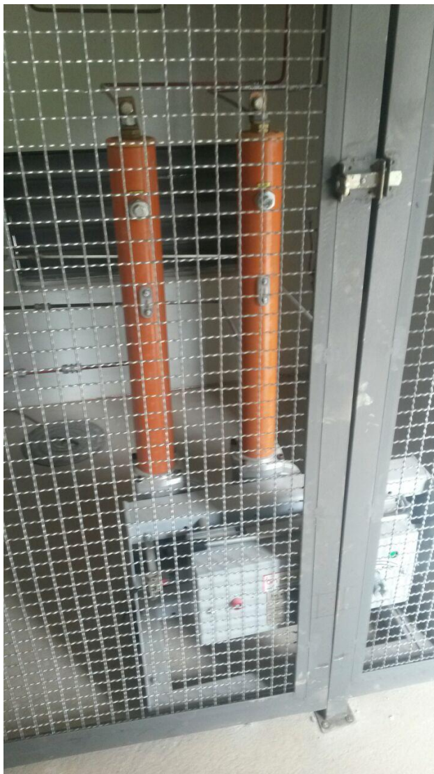
Figura 41 - Baia de proteção, disjuntor de média tensão
