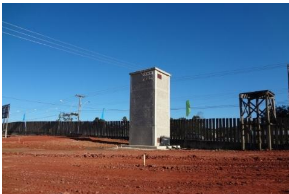
Figura 3 - Subestação tipo 3 - Cubículo de medição a 3 elementos
