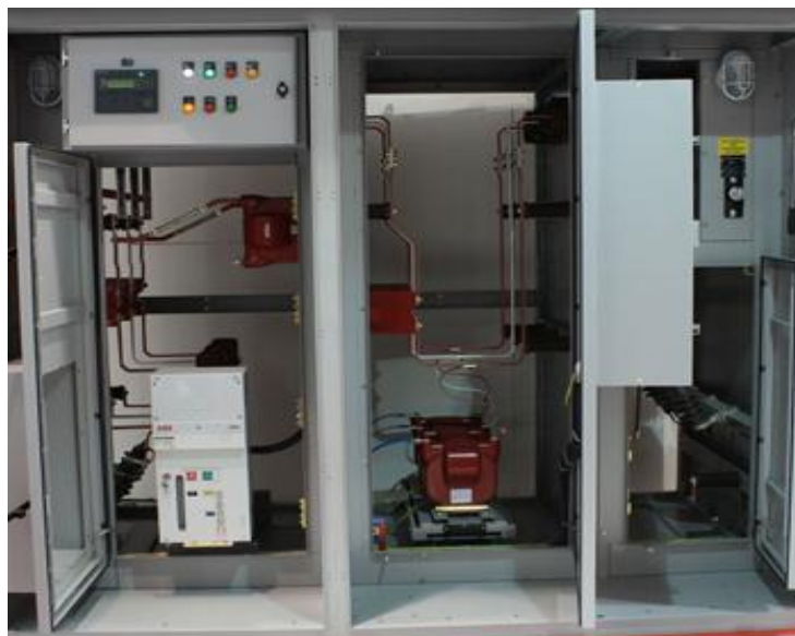
Figura 4 - Subestação tipo 4 - Subestação blindada de portas abertas
