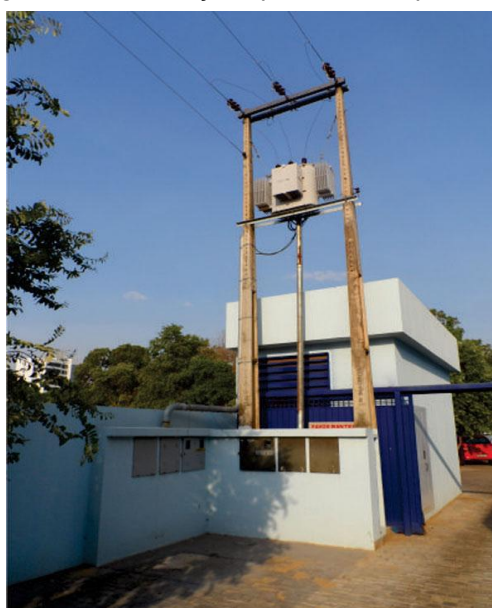
Figura 7 - Subestação tipo 1 e 2 compartilhada
