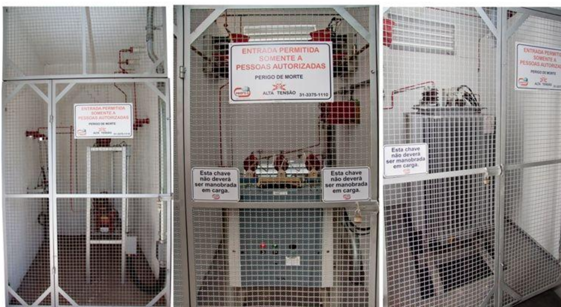
Figura 5 - Subestação tipo 5 - Medição, proteção e transformação
