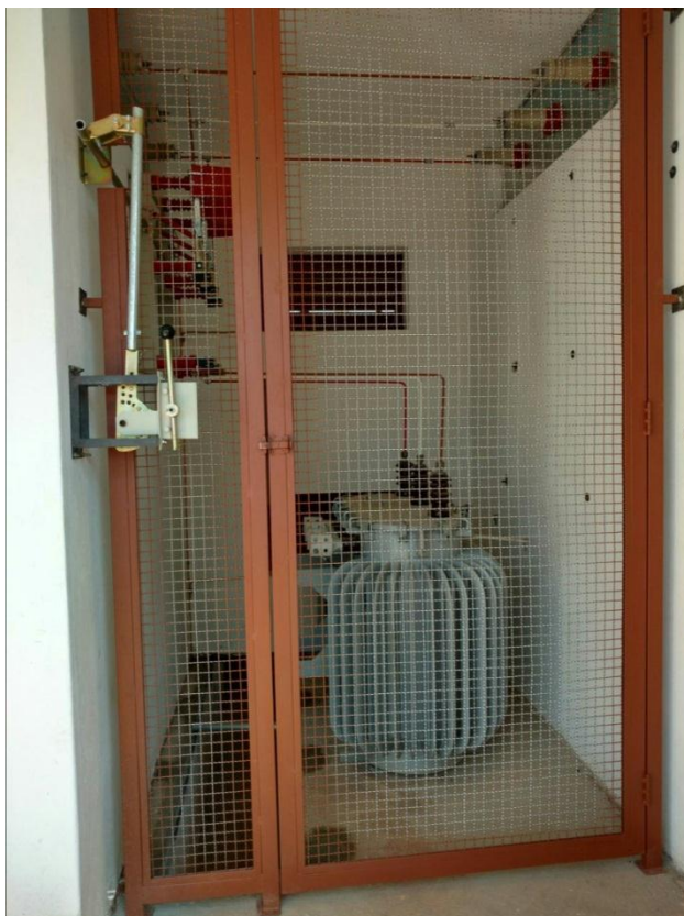
Figura 44 - Baia de transformação
