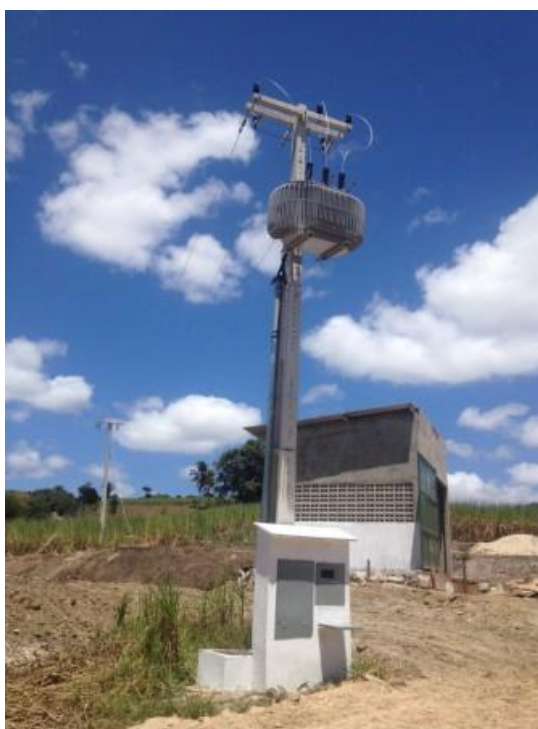
Figura 1 - Subestação nº1: Transformador instalado em poste de seção circular 10x600 ou 11x600
