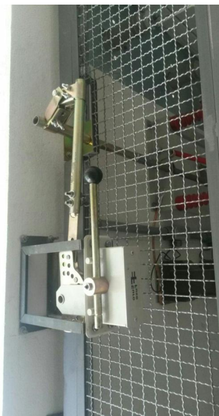
Figura 42 - Alavanca de acionamento de chave seccionadora tripolar da baia de proteção
