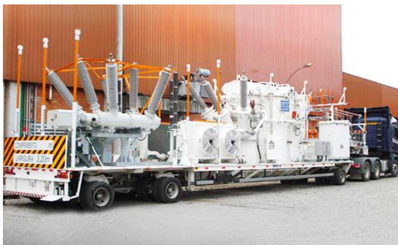
Figura 6 - Subestação tipo 6 - Subestação blindada instalada em carreta móvel
