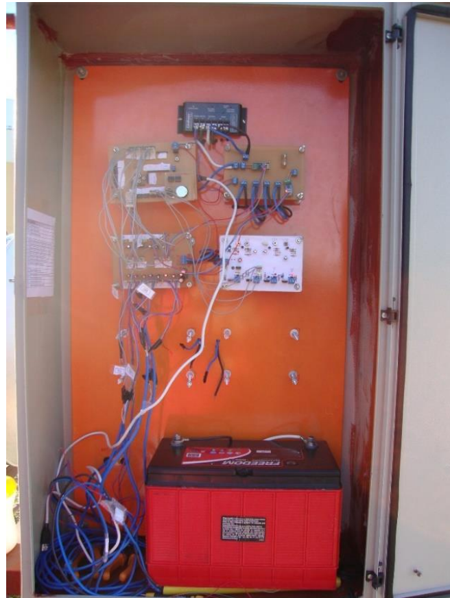
Figura 18 Sistema Centralizado de Controle da Planta solar.
