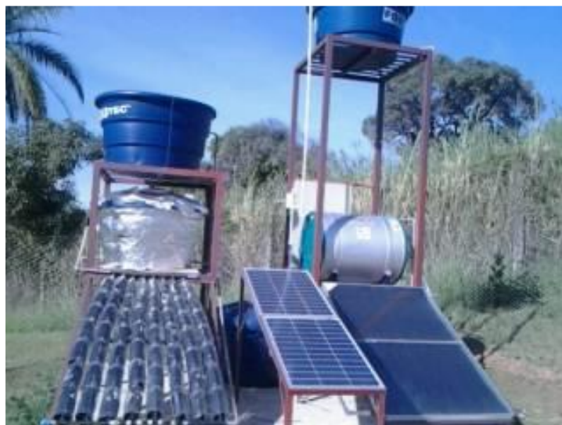
Figura 15 Planta Solar do IFMG.
