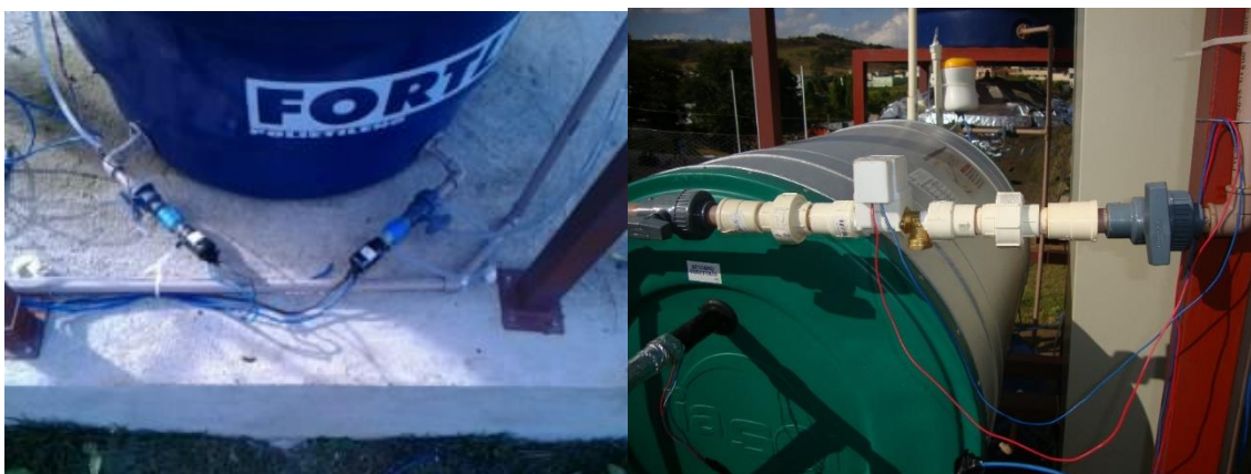
Figura 14 Reservatório, Bomba d'água e Válvula Solenoides.
